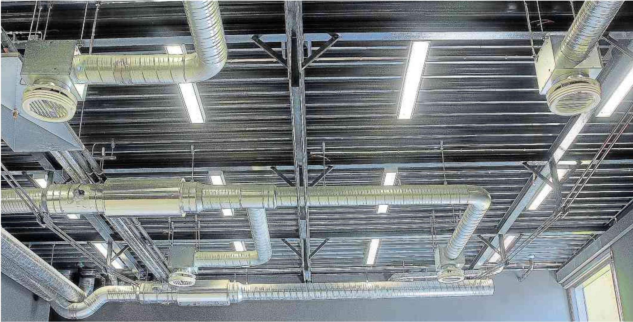
Auch die Lüftungstechnik im Neubau des Stadttheaters Koblenz wurde im Ingenieurbüro Bernardi konzipiert.
