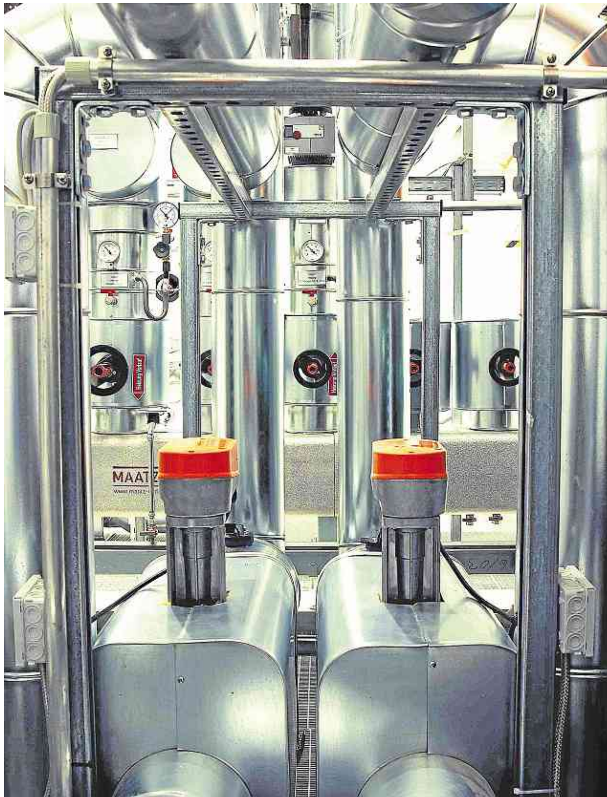
Nein, dies ist keine Kunst am Bau, sondern ein Detail der Heizzentrale der neuen Rhein-Mosel-Halle. Diese hat ein hochkomplexes Innenleben, das kaum ein Besucher je zu Gesicht bekommt.
